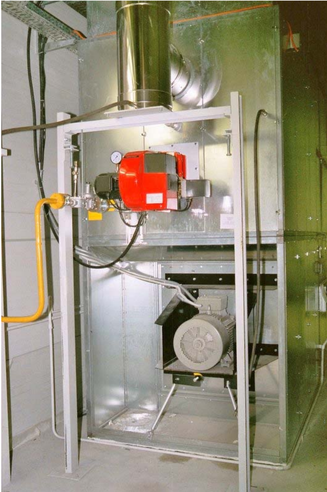
Brenner und Lüftung
