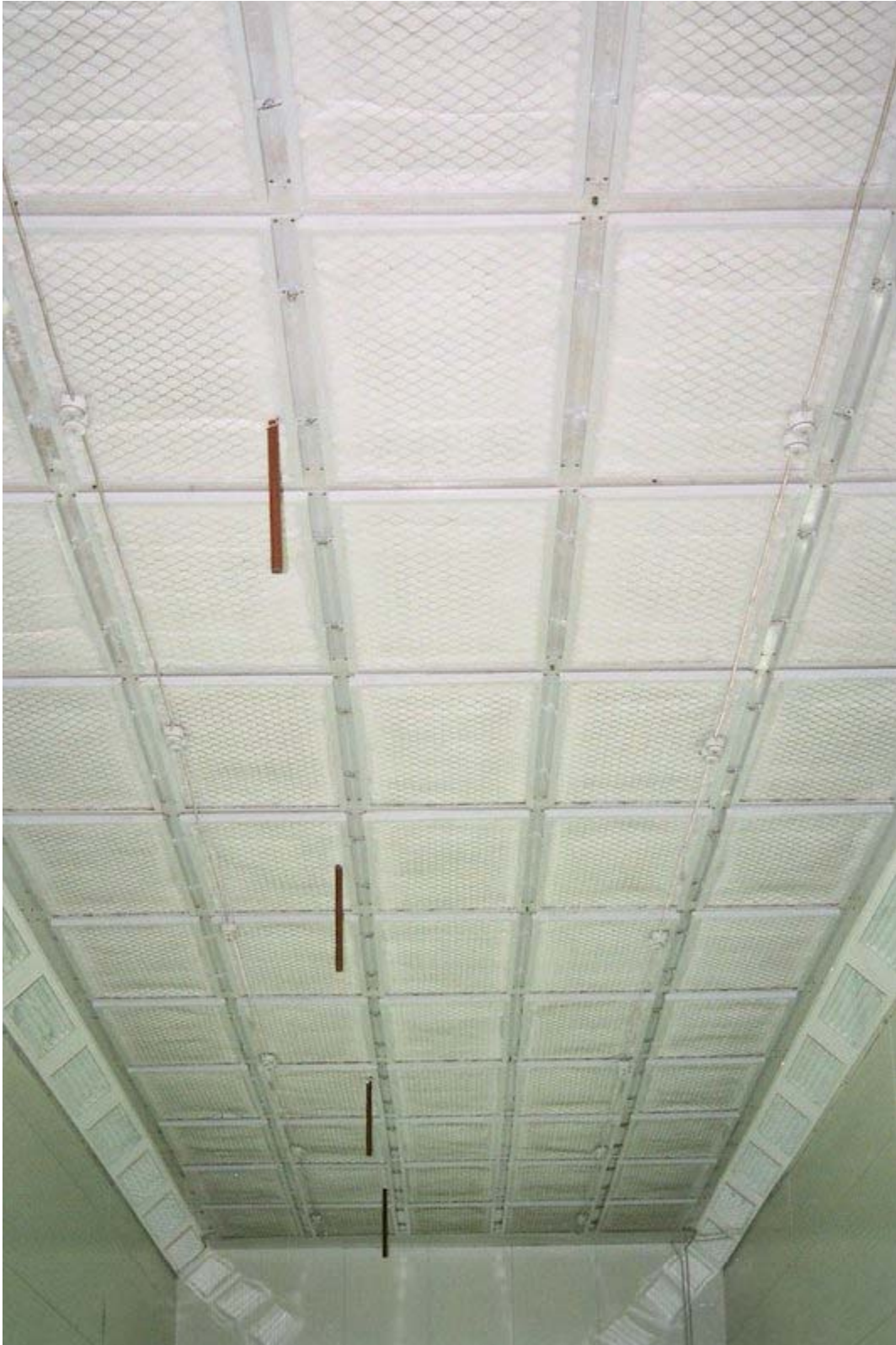
Filterdecke mit Beleuchtung
