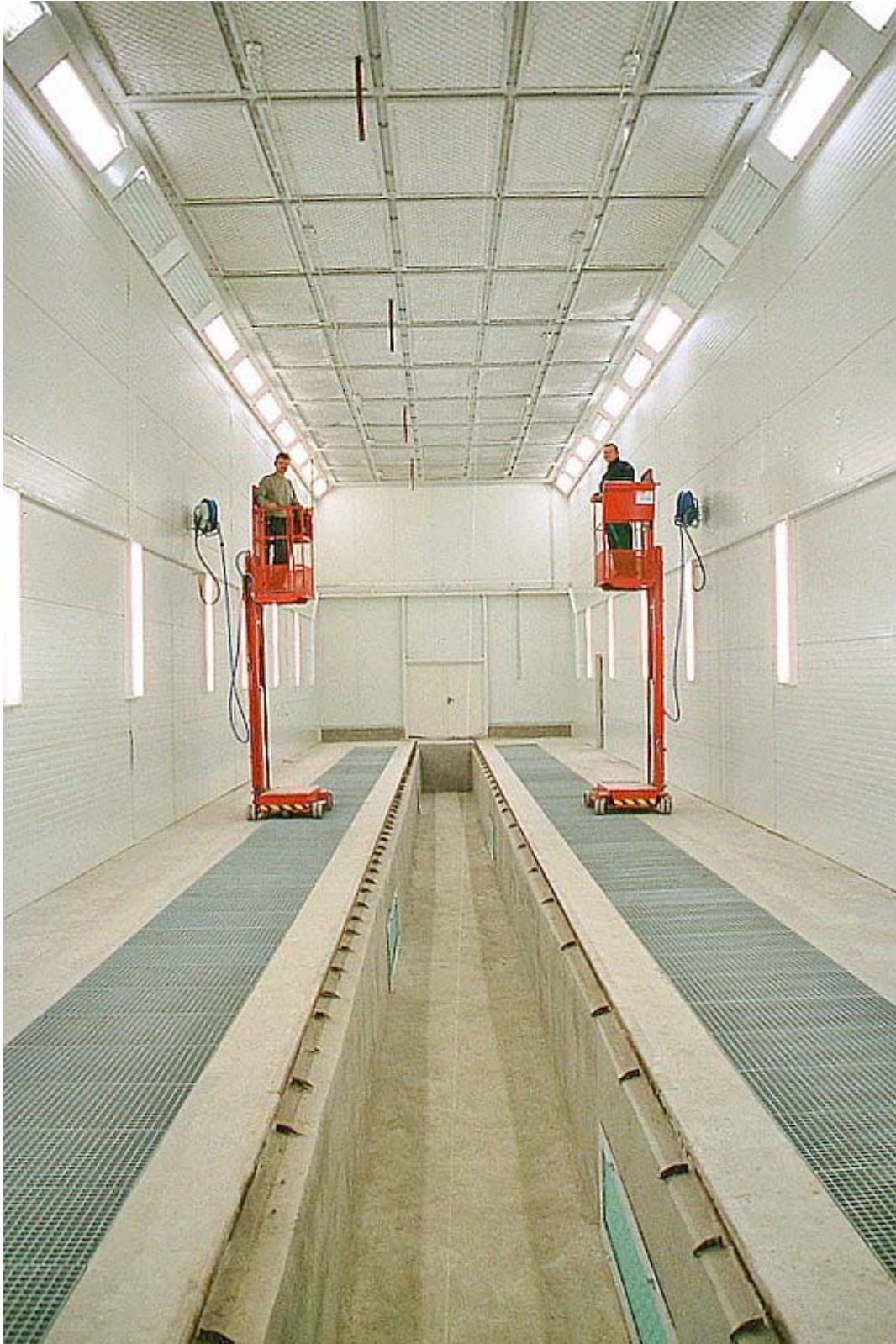
Lackierhalle mit Grube
