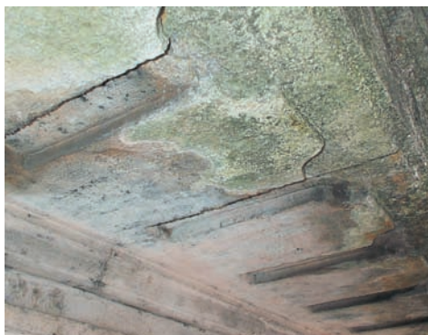
Starke Kalksinterbildung an der Untersicht der Brüstung
