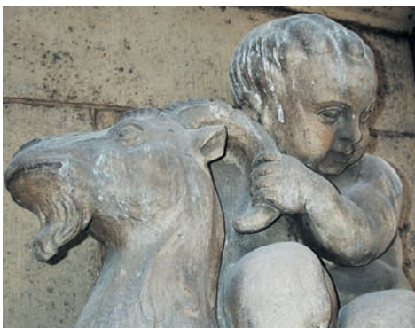
Detail vor der Reinigung mit Gipskrusten und Verschmutzung
